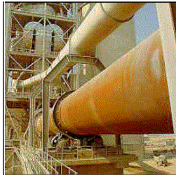
Four de cimenterie
